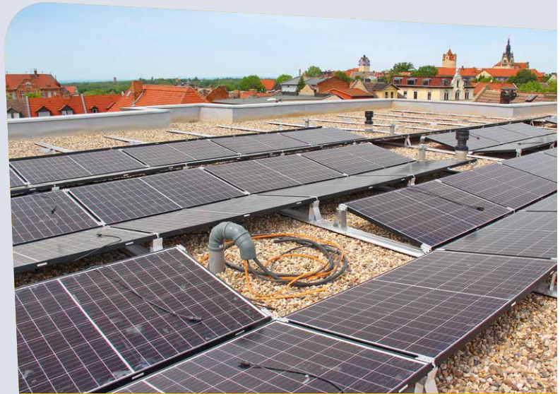
Ansicht der PV-Anlage auf der Dachfläche des Sophienstiftes am Louis-Braille-Platz
